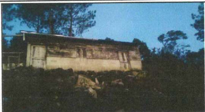
Se observa muro el estado se necesita levantar concreto
