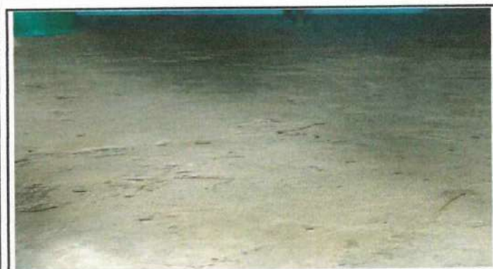
Se observa el piso en mal estado.
